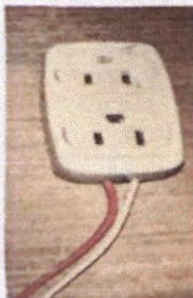
Foto 7: Sustrucion de tomacorriente doble
