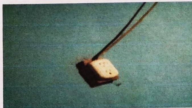
Foto 4: RENGLO 17. 8 SUSTITUCION DE TOMACORRIENTES DOBLES
