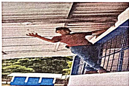
sustitución de focos
