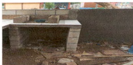
Foto 6: Mantenimiento a estufa rural
