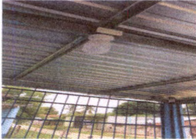
Foto 13: Sustrución de focos ahorradores
