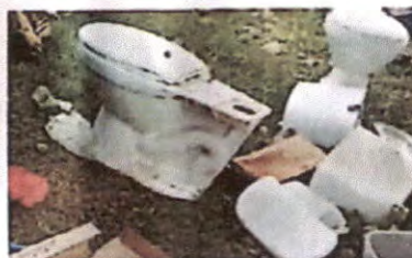
SUSTITUCIÓN DE ACCESORIOS PARA BAÑO
