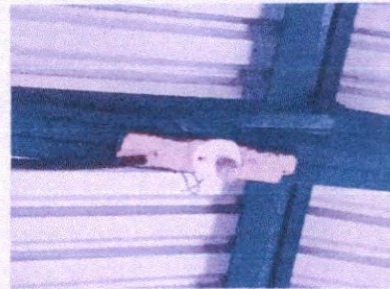
Foto 10: Sustrucción de plafoneras
