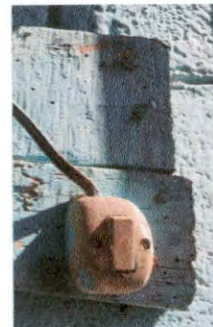
Foto 8: Sistema Electrico, interruptor simple
