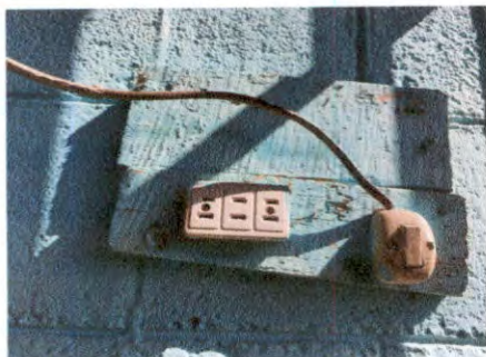
Foto 7: Sistema electrico, tomacorriente doble
