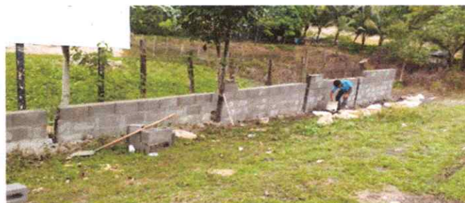
Foto 4: Pegado de block al nivel del asfalto, falta colocar los tubos galvanizados y malla
