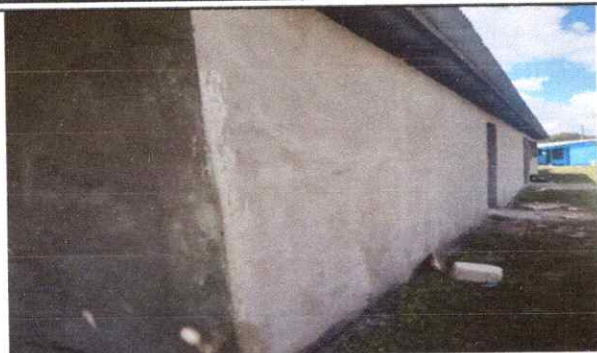
Foto 1: CEBIDO EN MUROS
