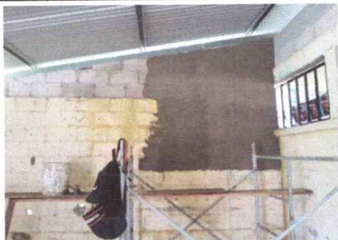
Foto 1: CERNIDO EN MUROS
