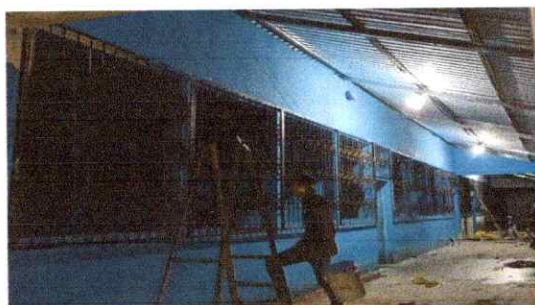
Foto 5: Cambio de focos ahorradores
