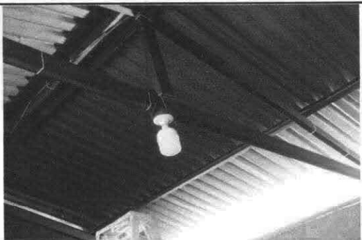
Foto 1: Focos ahorradores instalados
