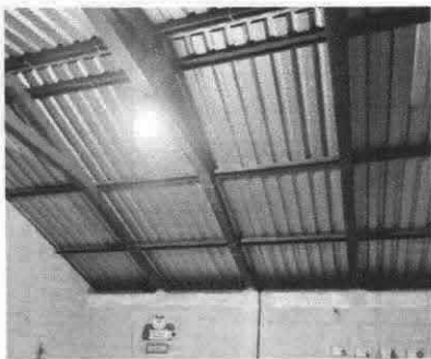
Foto 3: Focos ahorradores funcionando a la perfección
