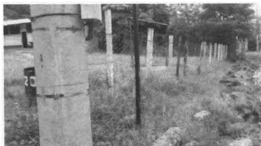
Foto 2: Postes en mal estado
