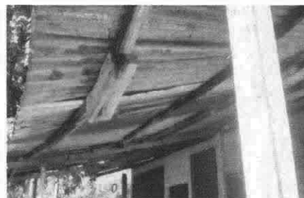
Foto 2: Vigas a punto de quebrarse.
