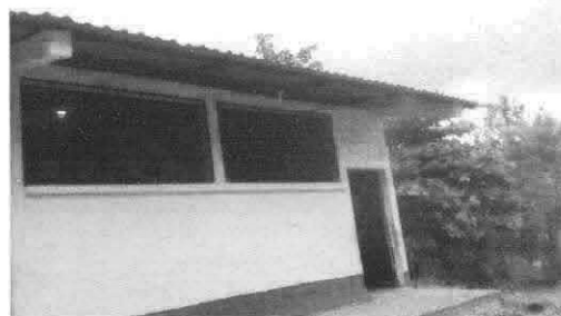
Foto 6: Pintar para mejor vista en las aulas.
