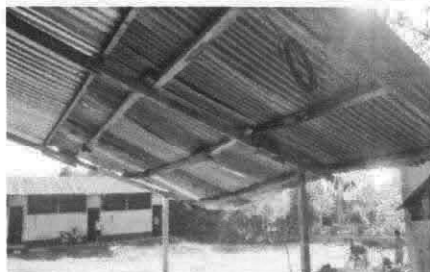
Foto1: Galera en mal estado.
