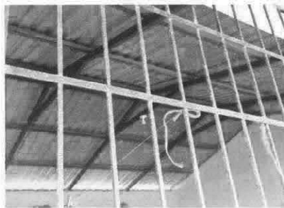
Foto 2: balcones sin pintura y oxidados.
