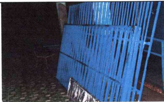
Foto 3: Sustrucción de estructura de metal de ventana
