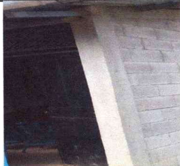
Foto 6: Sustrucción de chapa
