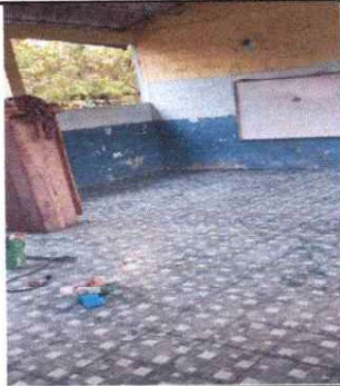
Foto 1: Sustrucción de piso de torta de concreto
