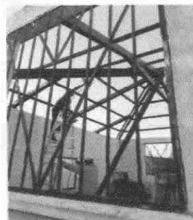
Foto 2: Cambio de lámina y estructura dañadas
