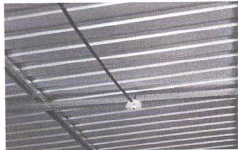
Foto 6: Sustrucción de ducto eléctrico + accesorios
