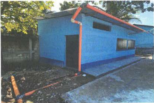
BAJADA DE AGUAS PLUVIALES
