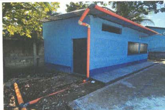
BAJADA DE AGUAS PLUVIALES
