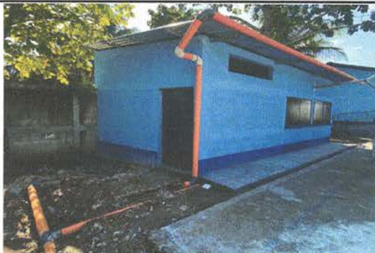
BAJADA DE AGUAS PLUVIALES
