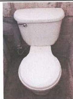
Foto 6: Servicios Sanitarios y sus accesorios
