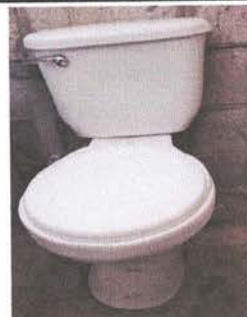
Foto 6: Servicios Sanitarios y sus accesorios
