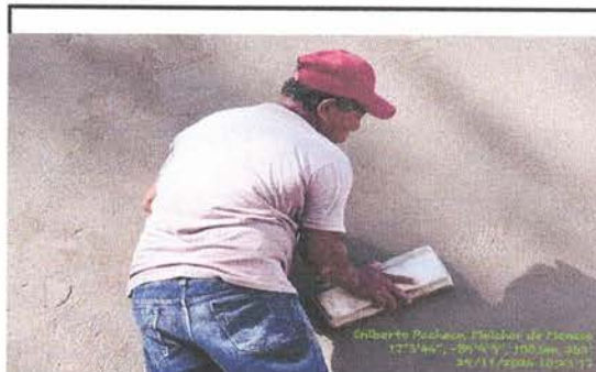
Foto 12: Cernido en muro (Cocina)
