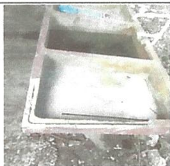
Reparacion o sustitucion de deposito de agua.
