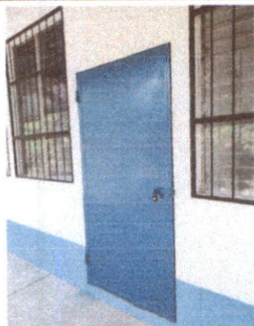
Foto 1: Puertas de Metal: Mantenimiento
