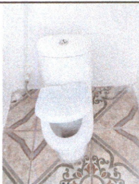
Foto 5: Servicios sanitarios y sus accesorios
