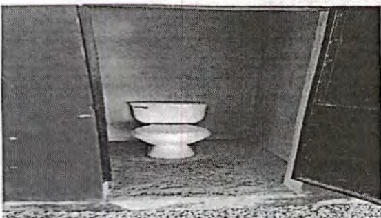
Foto 3: VISTA DEL ÁREA INTERIOR DEL MÓDULO II, SE OBSERVA LA NECESIDAD DE INSTALAR PISO, AZULEJO Y PINTURA.
