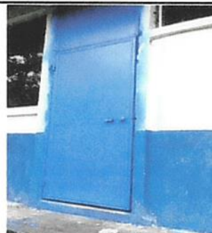
Foto 6: Sustrucción de Puerta
