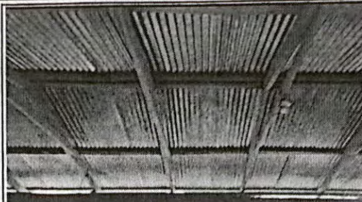
Foto2: vista del modulo, se observa la necesidad del cambio de estructura.
