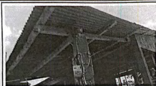
Foto1: vista del modulo, se aprecia que necesita un cambio de techo.
