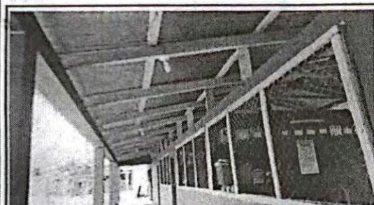
Foto 3: vista del modulo, se ve la necesidad de cambio de balcones.
