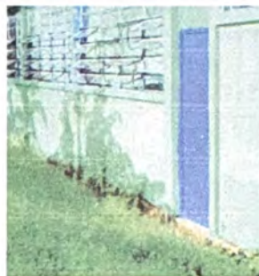
Foto 10: REMOZAMIENTO EN PUERTA DE METAL
