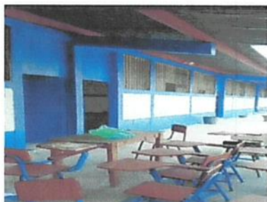
Foto 5: pintura en muro
