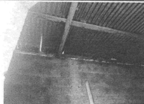
Foto 2: Estructura de Techo en mal estado
