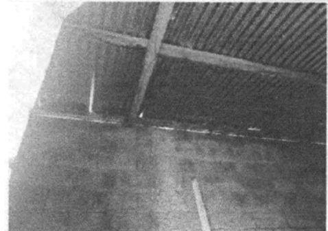
Foto 2: Estructura de Techo en mal estado
