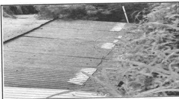
Foto 5: Se cambiará estructura y techo.
