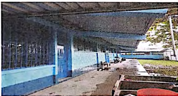
Foto 3: Soporte de estructura
