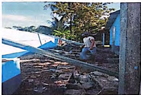
Foto 3: Soporte de estructura
