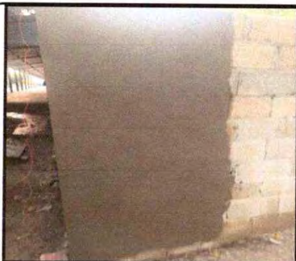
Foto 9: Cernido en paredes de cocina
