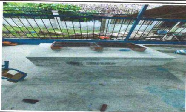
Foto1: MANTENIMIENTO A ESTUFA RURAL
