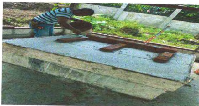
Foto1: MANTENIMIENTO A ESTUFA RURAL
