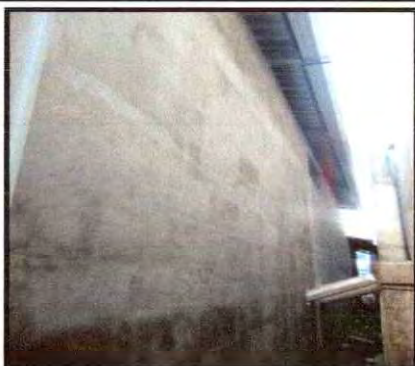
Foto 9: Cernido en paredes de cocina
