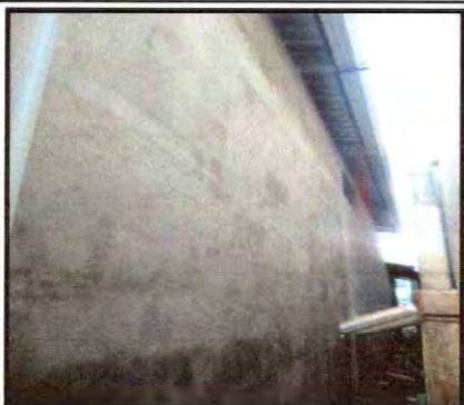
Foto 9: Cernido en paredes de cocina
