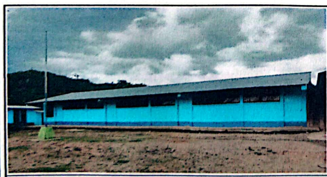
Foto 5: Sustitución de vidrios por balcones
