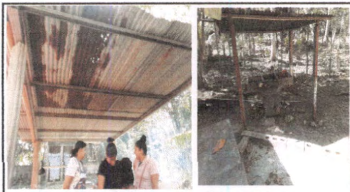
Foto 3: Vista del estado en que se encuentra el techo de la cocina y la pila de concreto.
