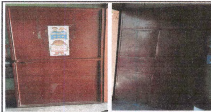
Foto 5: Vista general del estado de las puertas de las dos aulas de parvulos 1 y 2 y puerta del aula de parvulos 3.
