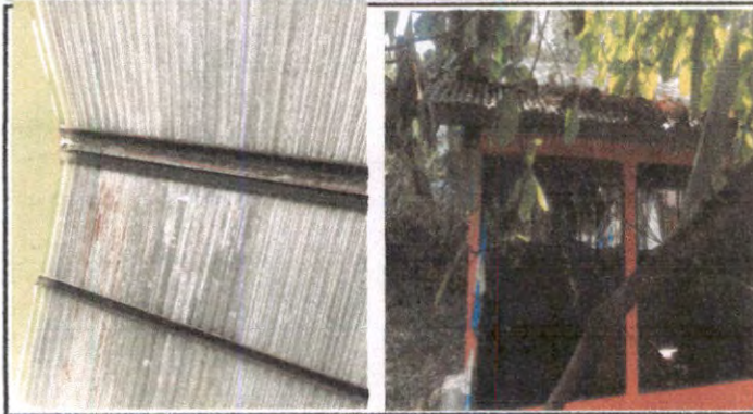
Foto1: Vista de como se encuentra el techo y estructura de aula de parvulos 1 y 2
