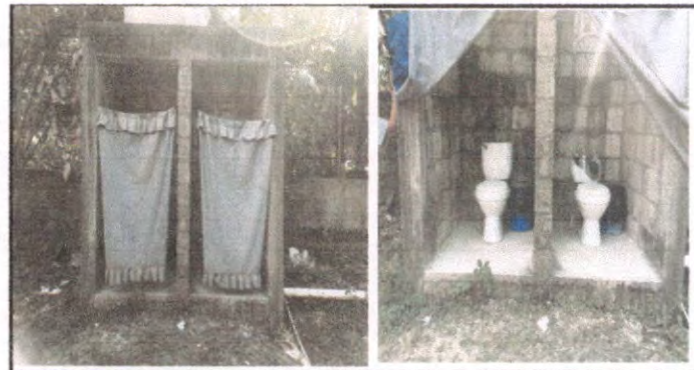
Foto 6: Vista general del estado en que se encuentran los baños de la escuelita, con cortina y baños en mal estado y sin conexión a caño de agua.
