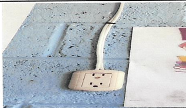
Foto 4: Sustrucción tomacorrientes dobles.
