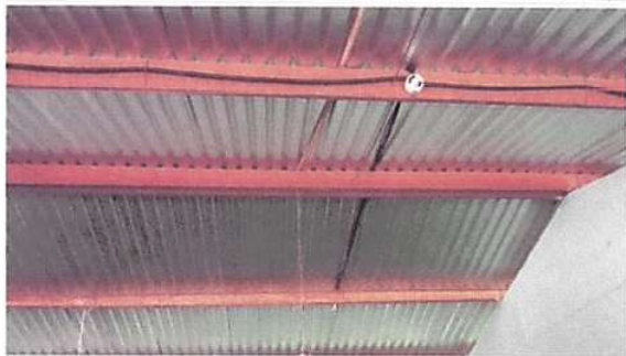
Foto 7: Sustrucción de ducto eléctrico mas accesorios
