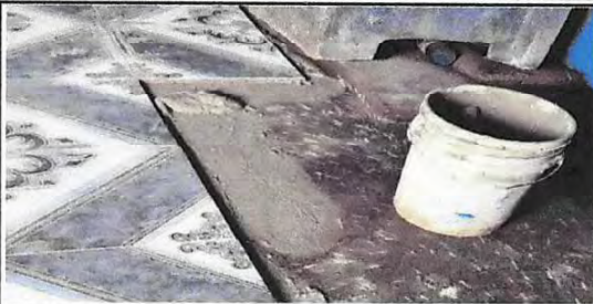
Foto 7: Sustrucción de piso cerámico
