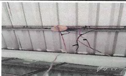
Foto 13: Sustrucción de plafoneras
