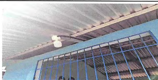
Foto 9: Sustrucción de plafoneras
