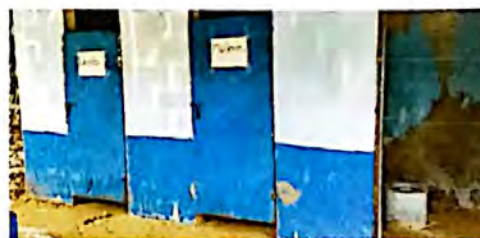
Foto 4: Estas son las puertas de los baños.
