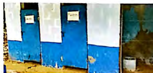
Foto 4: Estas son las puertas de los baños.
