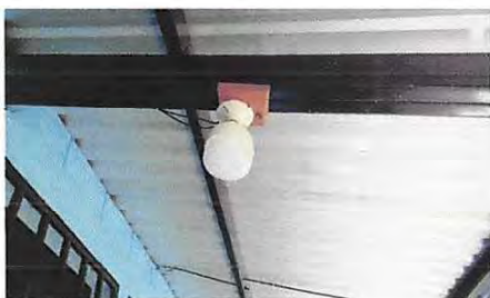
Foto 11: Sustrucción de lámparas tipo Led
