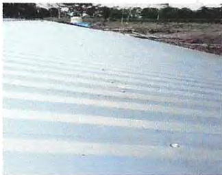
Foto 3: Sustrucción de elementos de fijación
