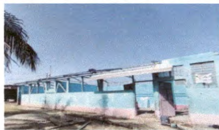
Foto 4: Sustrucción de elementos de fijacion
