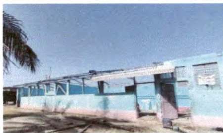
Foto 4: Sustrucción de elementos de fijacion
