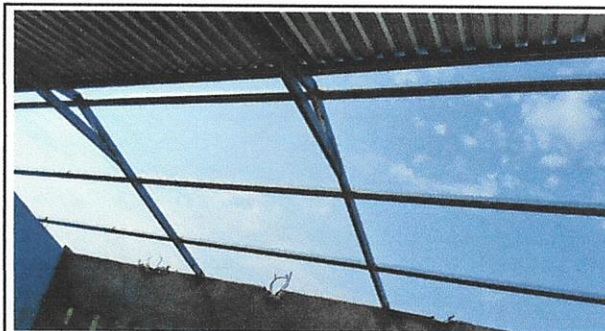
Foto 4: Fijación de lamina de 5 aulas una bodega y una dirección
