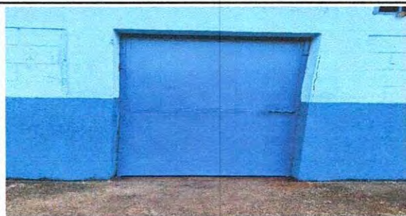
Foto 1: Sustrucción de puerta
