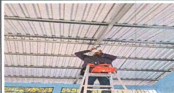
Foto 6: Sustrucción de plafoneras
